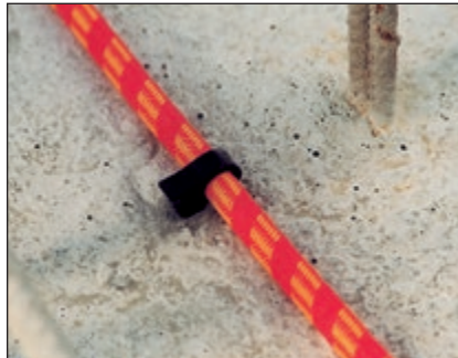
Befestigung mit Kunststoffclips, die vorher in den Frischbeton gesetzt wurden, oder ins Bohrloch Ø 8 mm eingeschlagen werden. Abstand 15 cm
